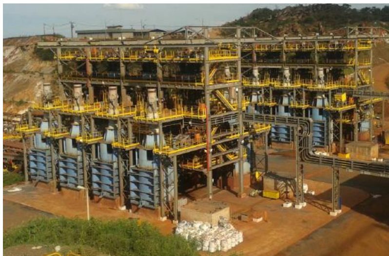
Figura 3. Circuito de remoagem do Minas Rio: cada prédio corresponde a uma linha de remoagem composta por oito moinhos e quatro baterias de hidrociclones classificando o concentrado em circuito fechado (acervo do autor).
